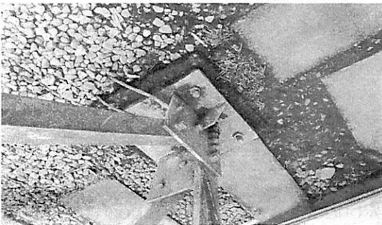
Foto 6, Torre de antenas
