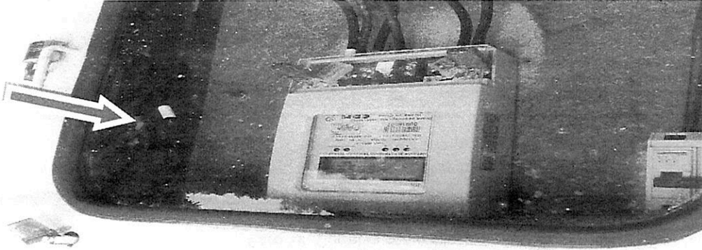
Foto 17. Medidor de Energía
