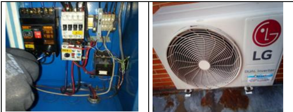
Fuente: Plan de Mantenimiento Equipos de Operación Crítica)
