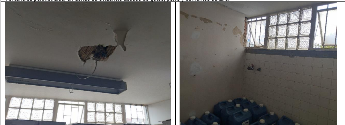
Techos y paredes con rupturas, cables y ventanas abiertas.
