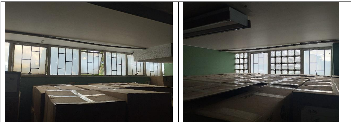
Ventanales perimetrales, en donde se evidenció acceso de gatos, polvo y corrientes de aire.
